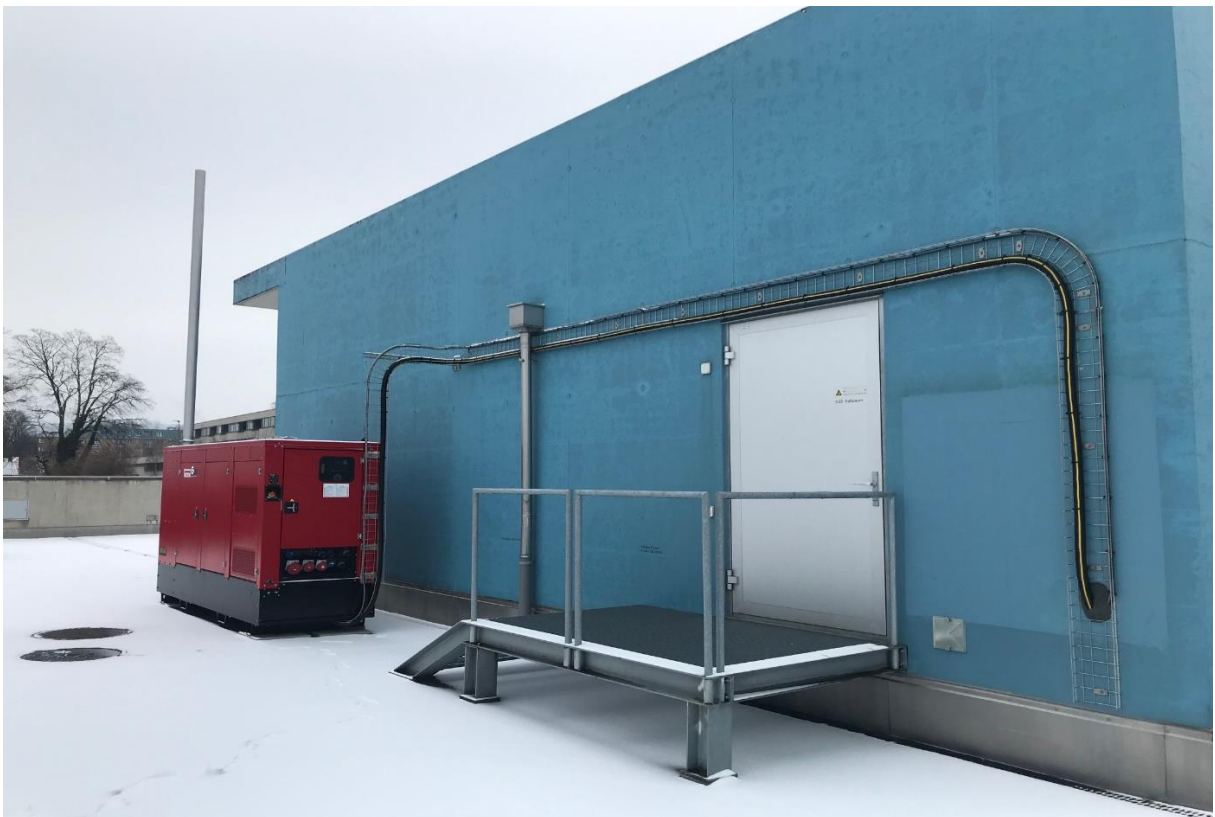
Notstromgruppe, hinter dem Betriebsgebäude Seewasserwerk Hirsacker
